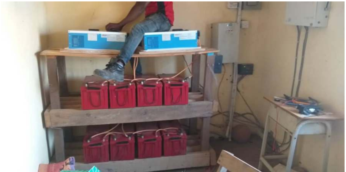
Das neu installierte Akkupaket der neuen Solaranlage
